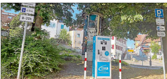
öffentliche E-Ladesäule in Hochdorf
